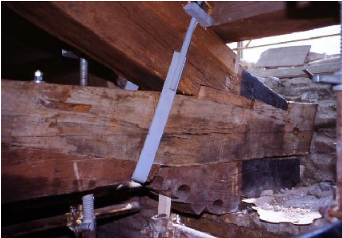
Intervento finito; da notare la tavola di quercia interposta in corrispondenza del dente di contrasto fra catena e puntone, a sostituzione di una parte del puntone cariata in intradosso.
