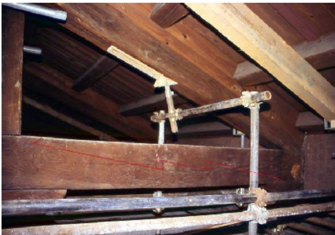
Profilo di taglio per la realizzazione dell'unione; da notare l'estremità nel muro cariata.
